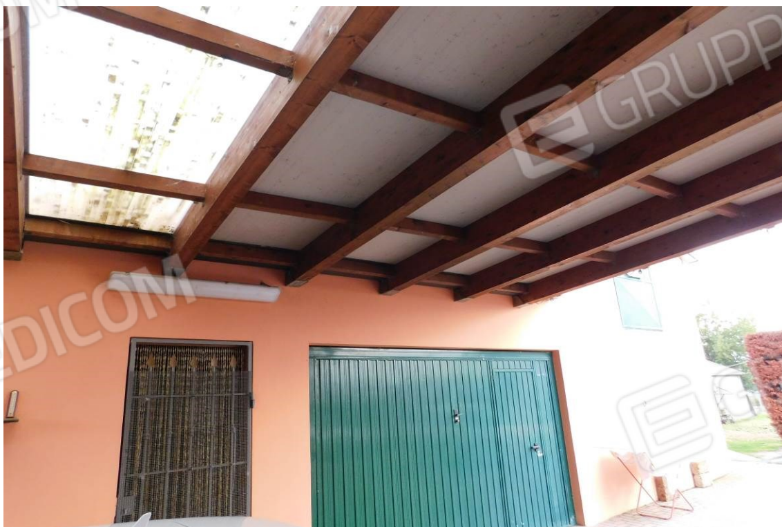
Foto 16 – Vista ingresso autorimessa (particolare tettoia di collegamento corpi di fabbrica non legittimata da titoli edilizi).
