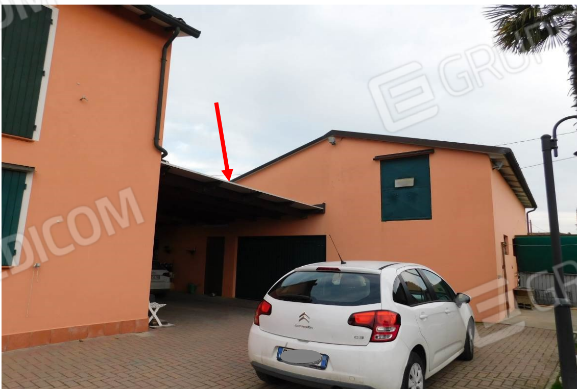
Foto 4 – Vista immobili da corte pertinenziale (particolare tettoia di collegamento corpi di fabbrica non legittimata da titoli edilizi).
