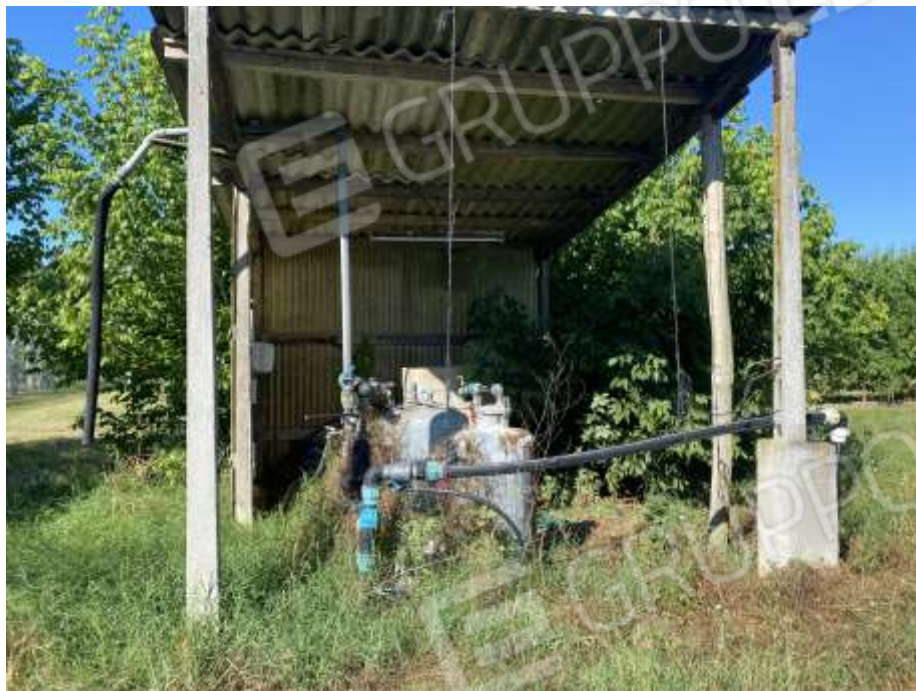
Tettoia priva di autorizzazioni
