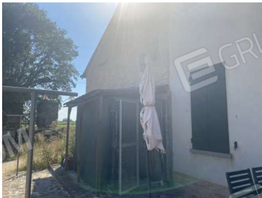
Tettoia priva di autorizzazione
