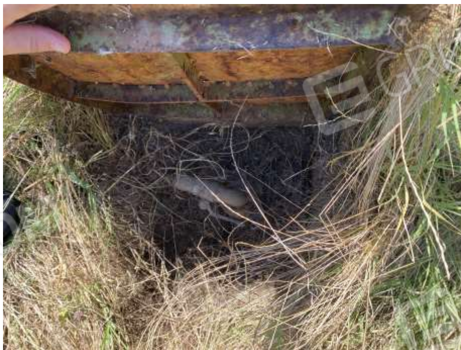
Pozzetti impianto irrigazione valvole manuali
