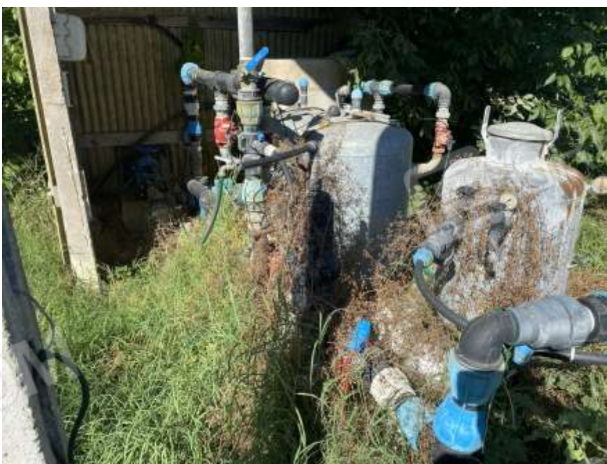
Impianto di irrigazione
