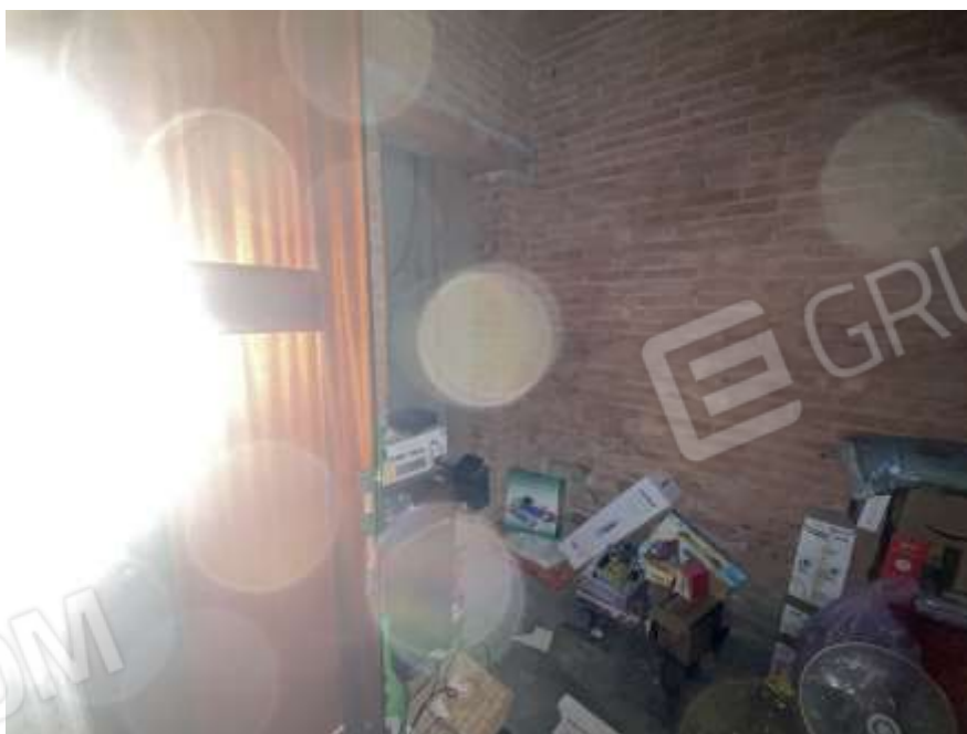
Interno piano terra unità abitativa sub 2 – bagno pt non realizzato
