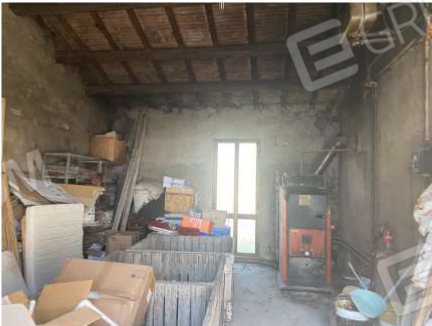
Interno capannone zona caldaia per riscaldamento abitazione
