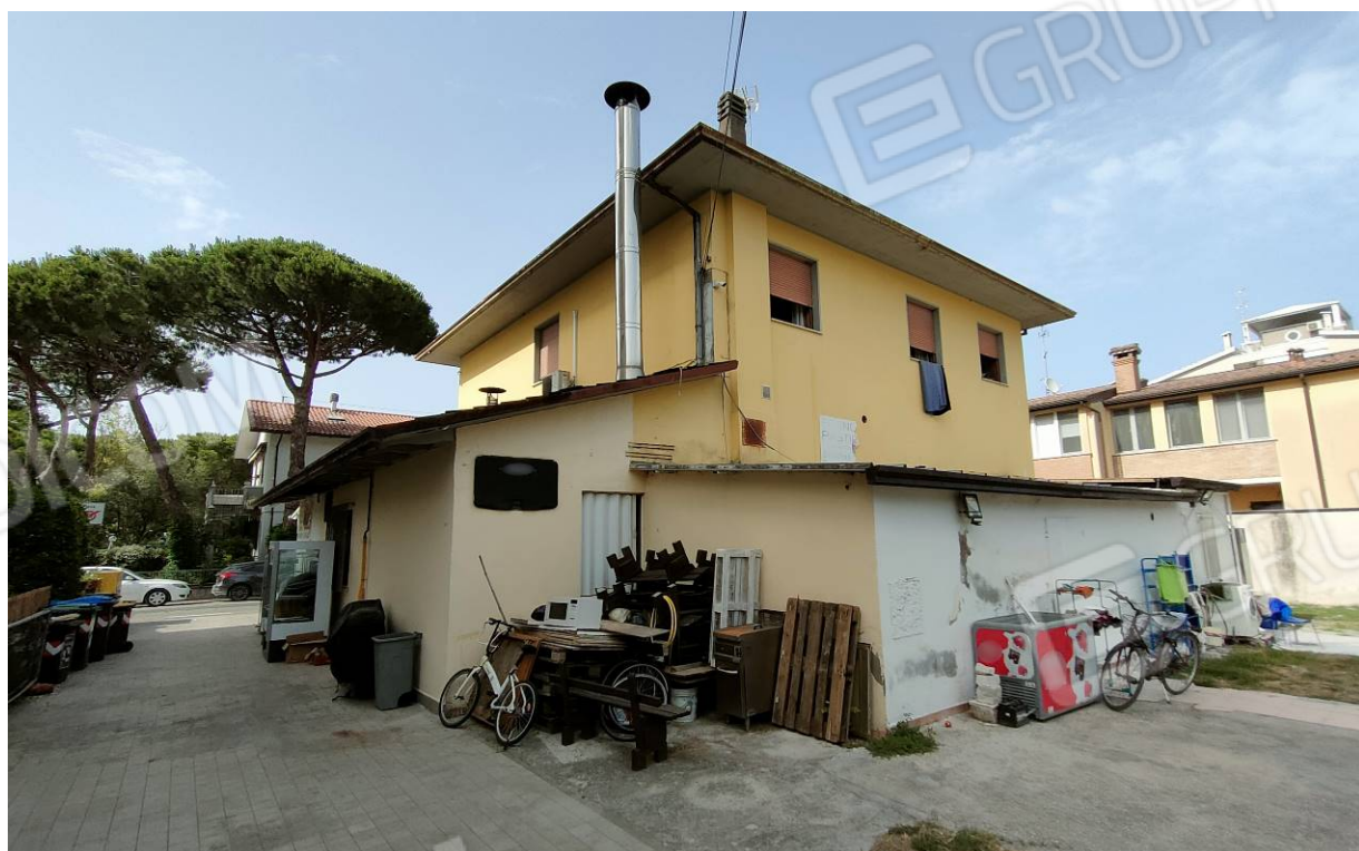
Vista lato sud-ovest del fabbricato ed in particolare del laboratorio al piano terra
