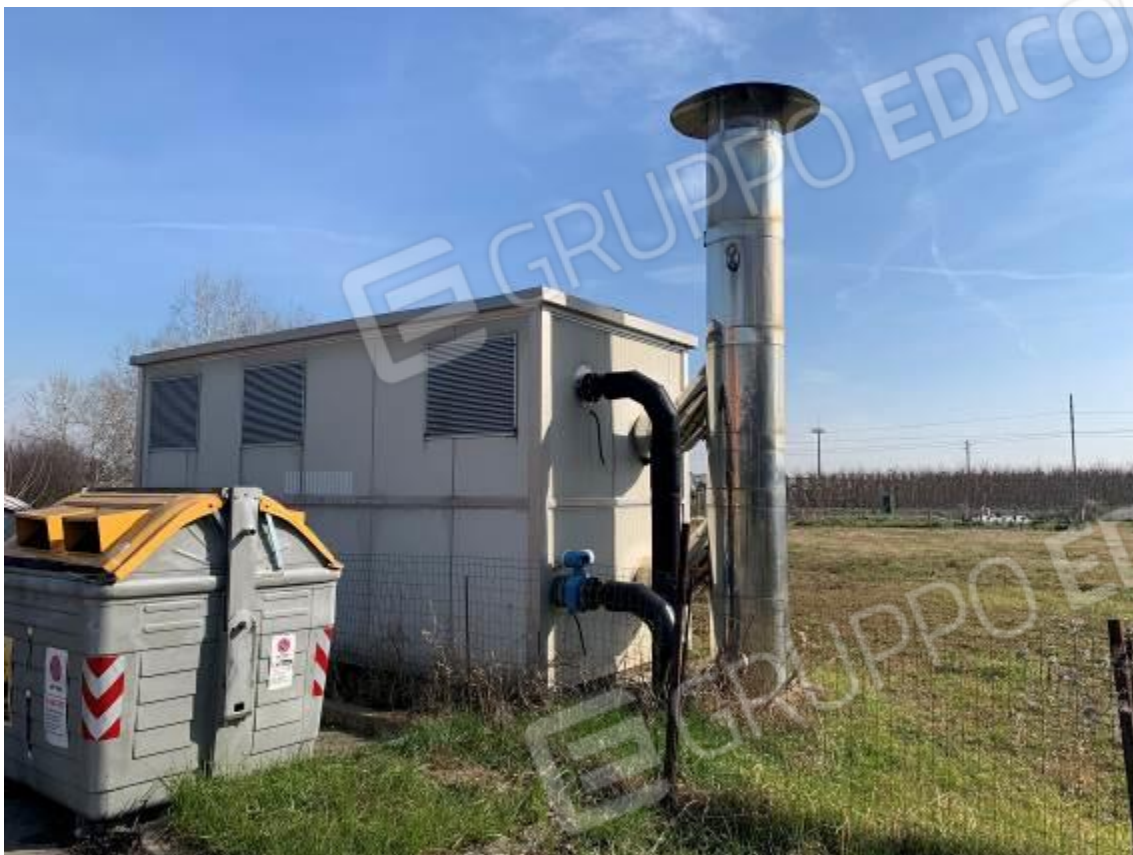
Foto 36: Centrale di teleriscaldamento
