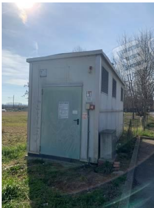
Foto 35: Centrale di teleriscaldamento
