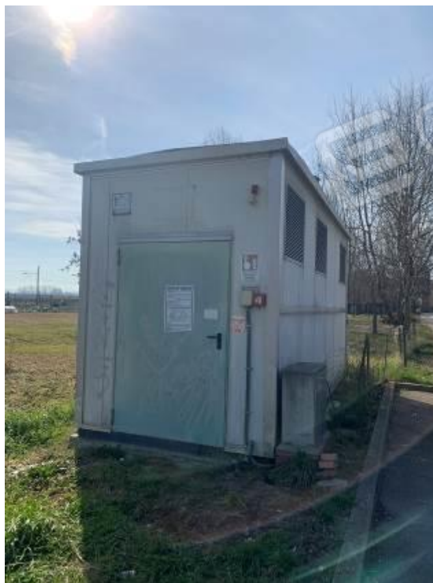
Foto 35: Centrale di teleriscaldamento
