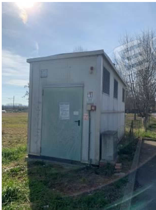
Foto 35: Centrale di teleriscaldamento
