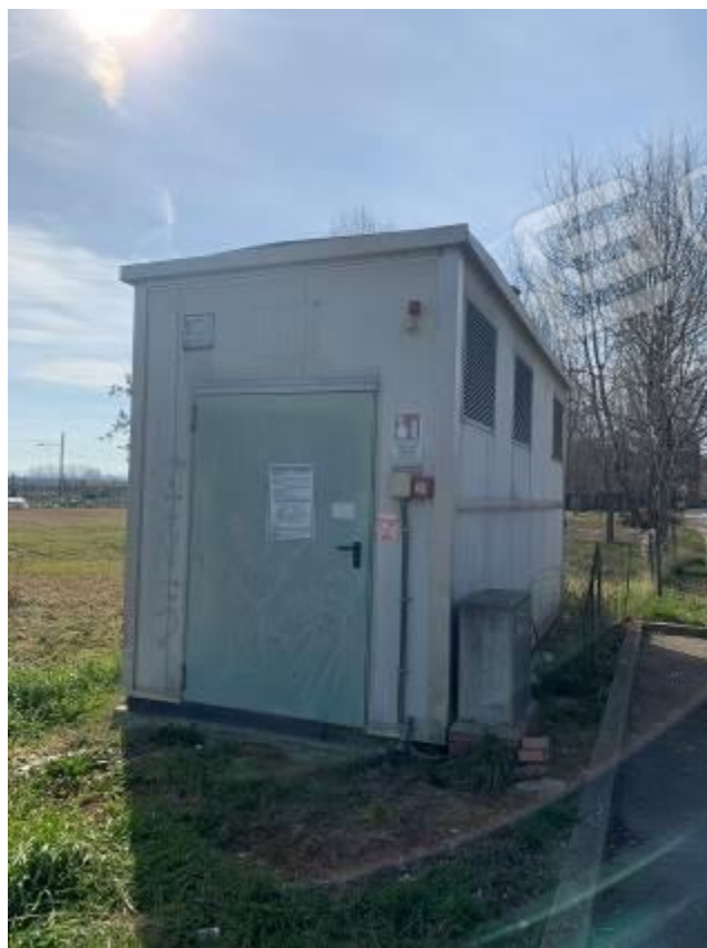
Foto 35: Centrale di teleriscaldamento
