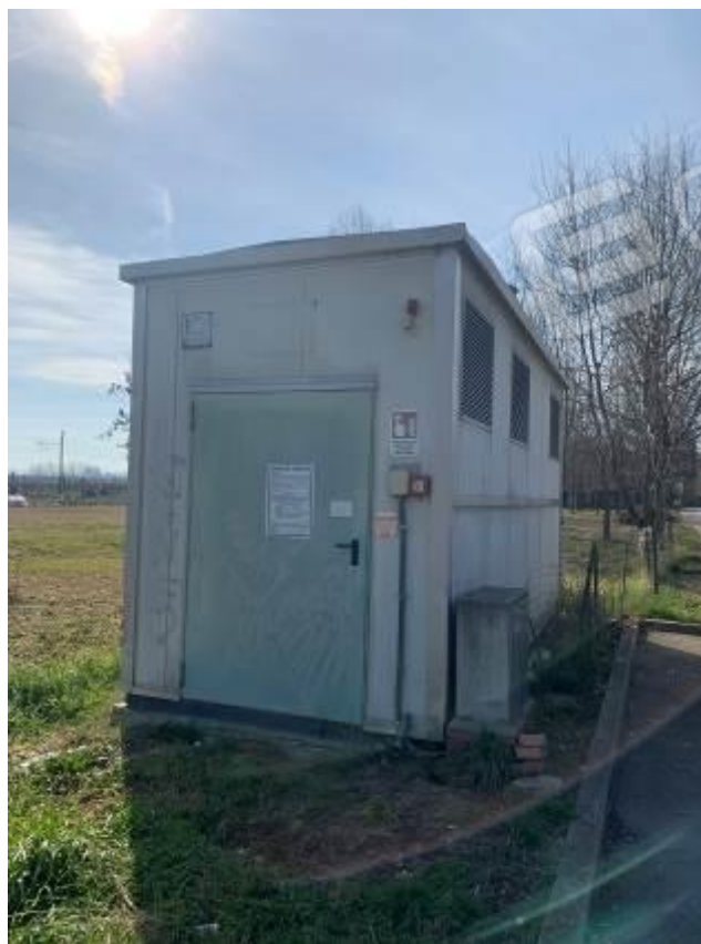
Foto 35: Centrale di teleriscaldamento
