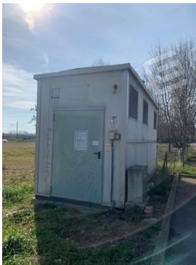
Foto 35: Centrale di teleriscaldamento
