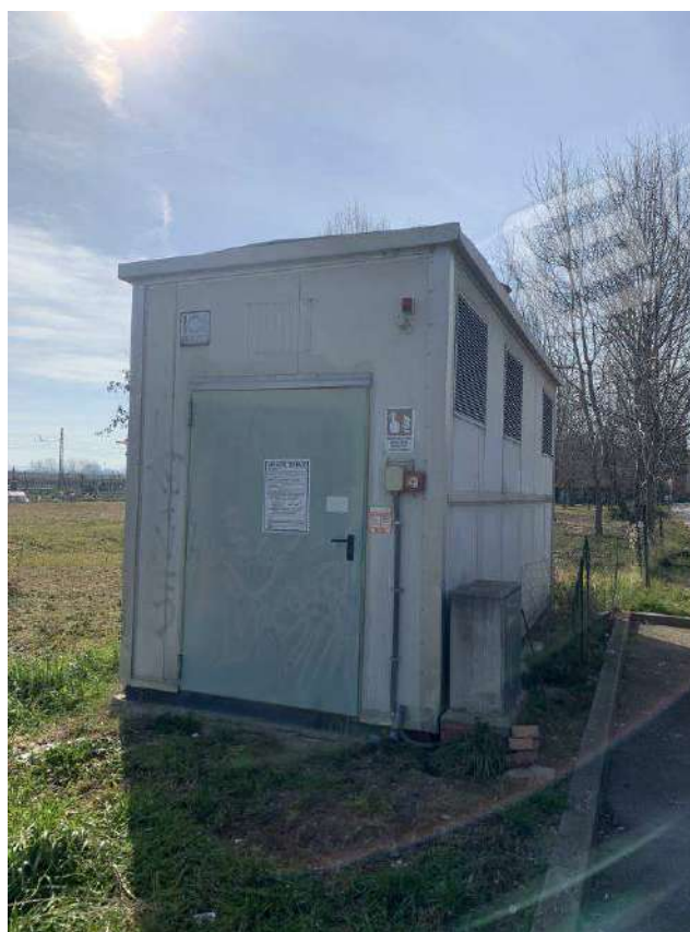
Foto 33: Centrale di teleriscaldamento
