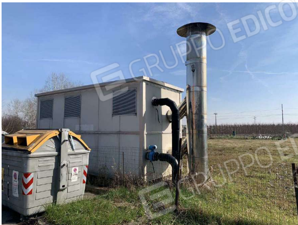
Foto 36: Centrale di teleriscaldamento
