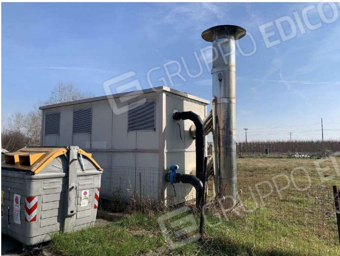
Foto 32: Centrale di teleriscaldamento
