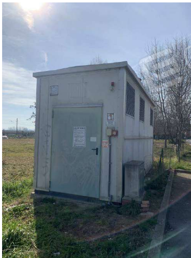
Foto 35: Centrale di teleriscaldamento
