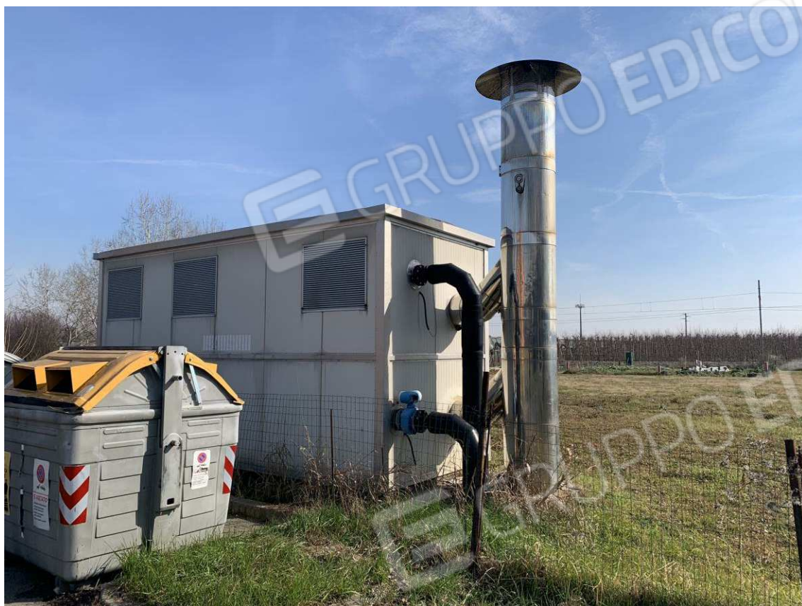
Foto 34: Centrale di teleriscaldamento
