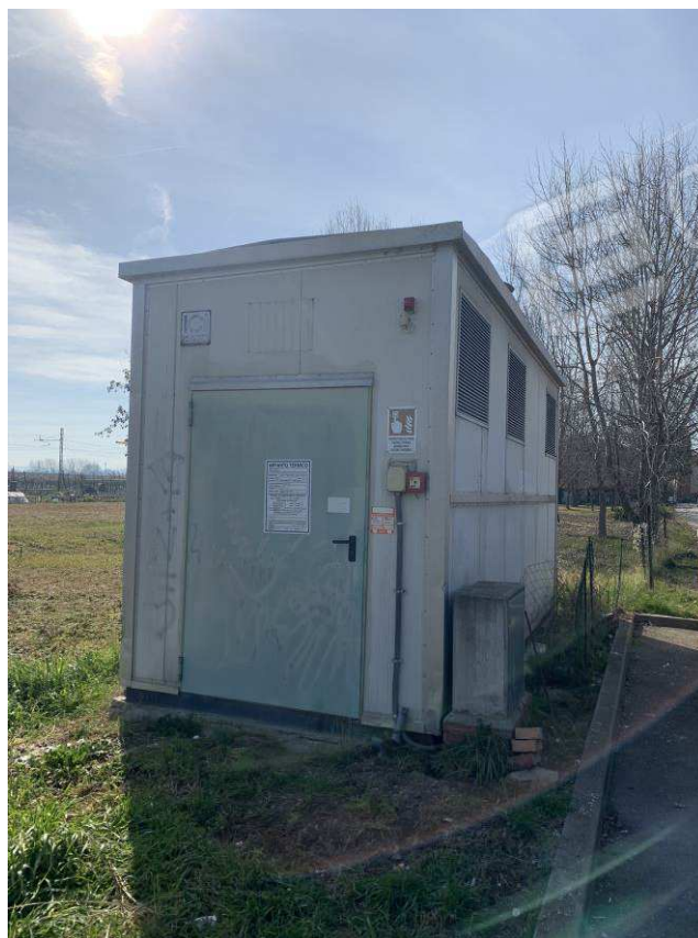
Foto 33: Centrale di teleriscaldamento
