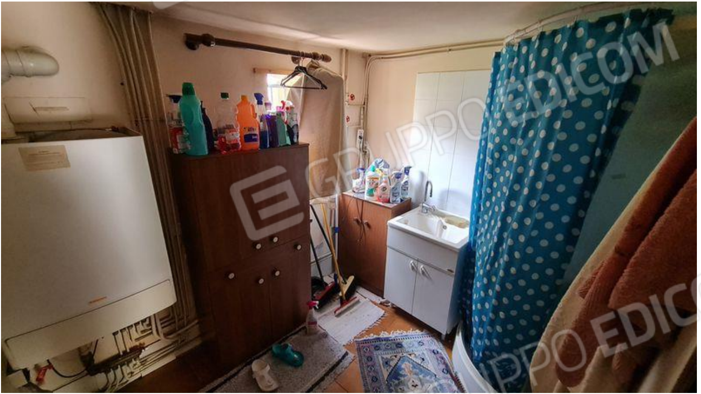
Centrale termica. (PT)
