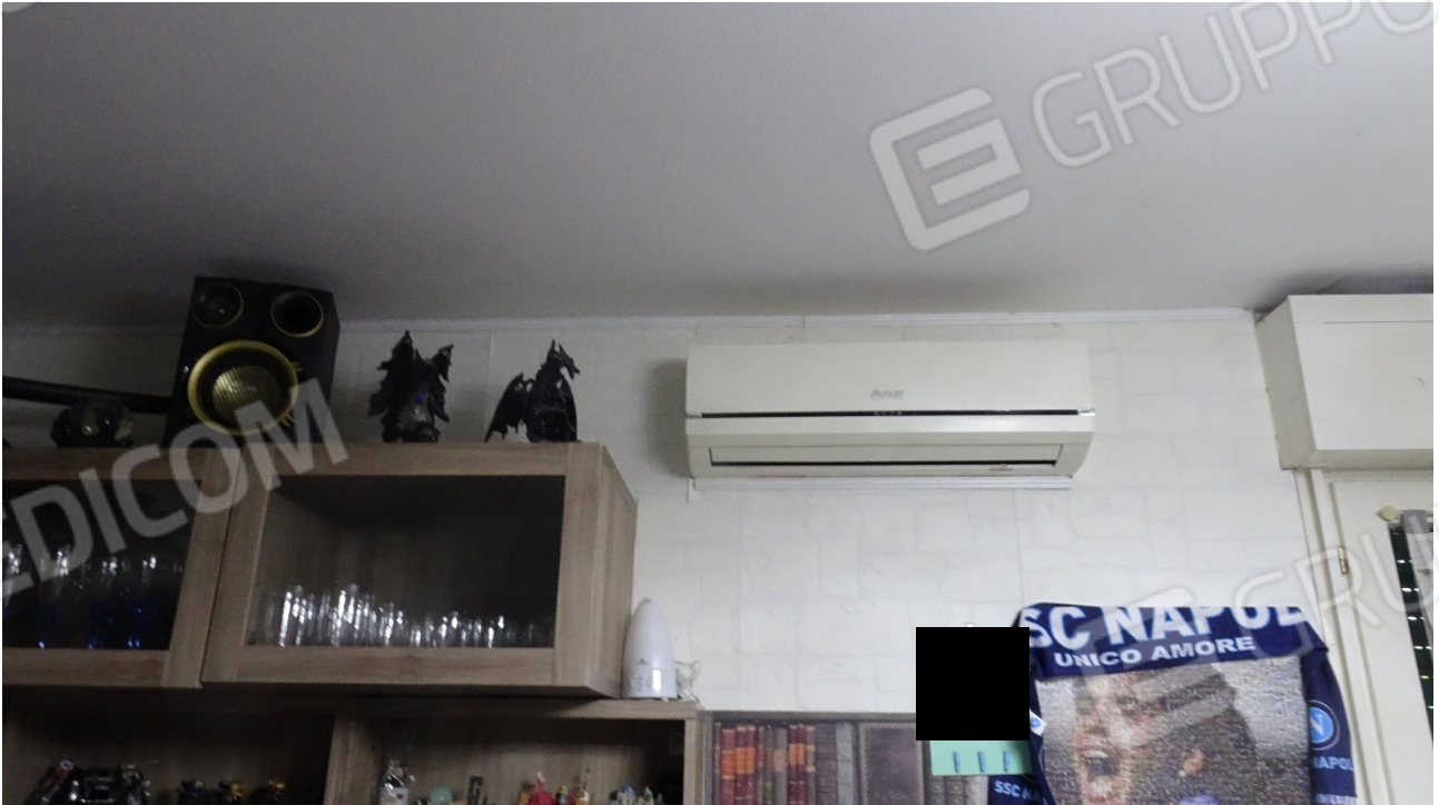
Foto 21_particolare aria condizionata
