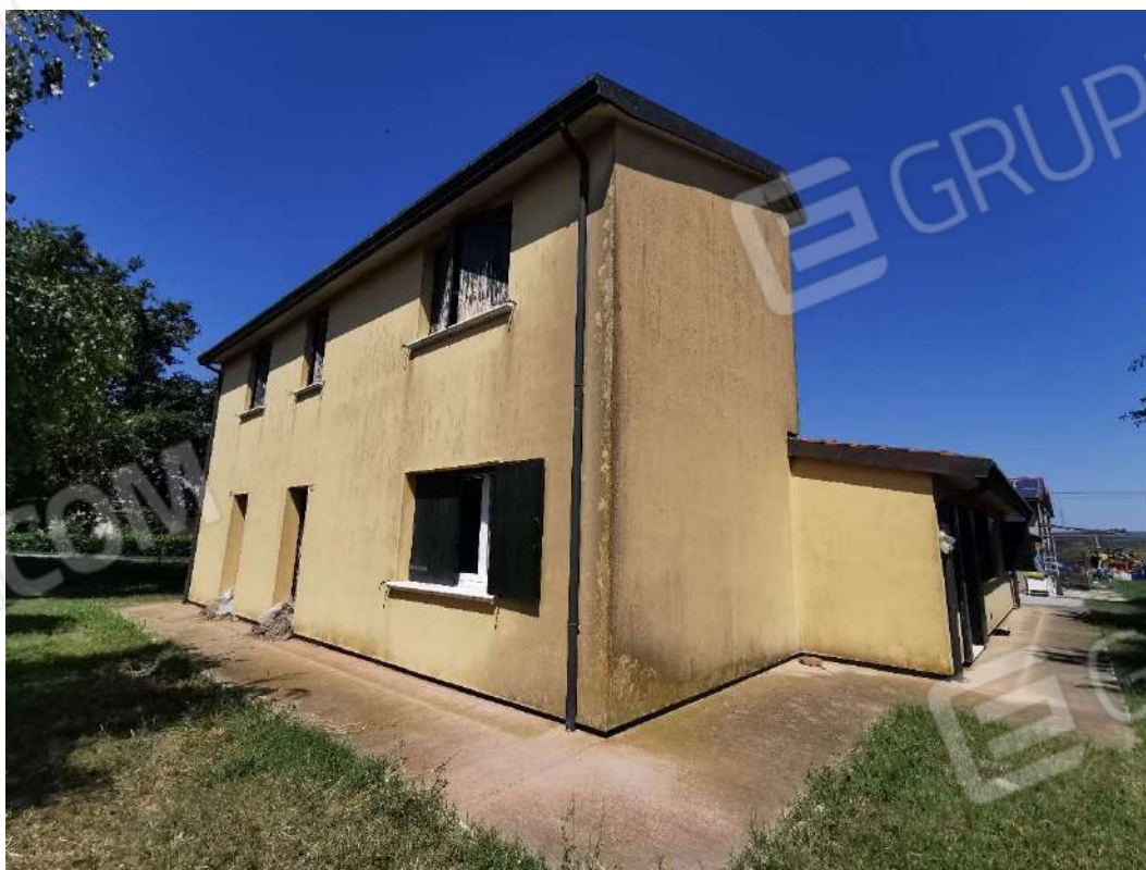
Vista esterna del fabbricato ad uso residenziale lato sud-est (F.127 Part.206 Sub.2-3)
